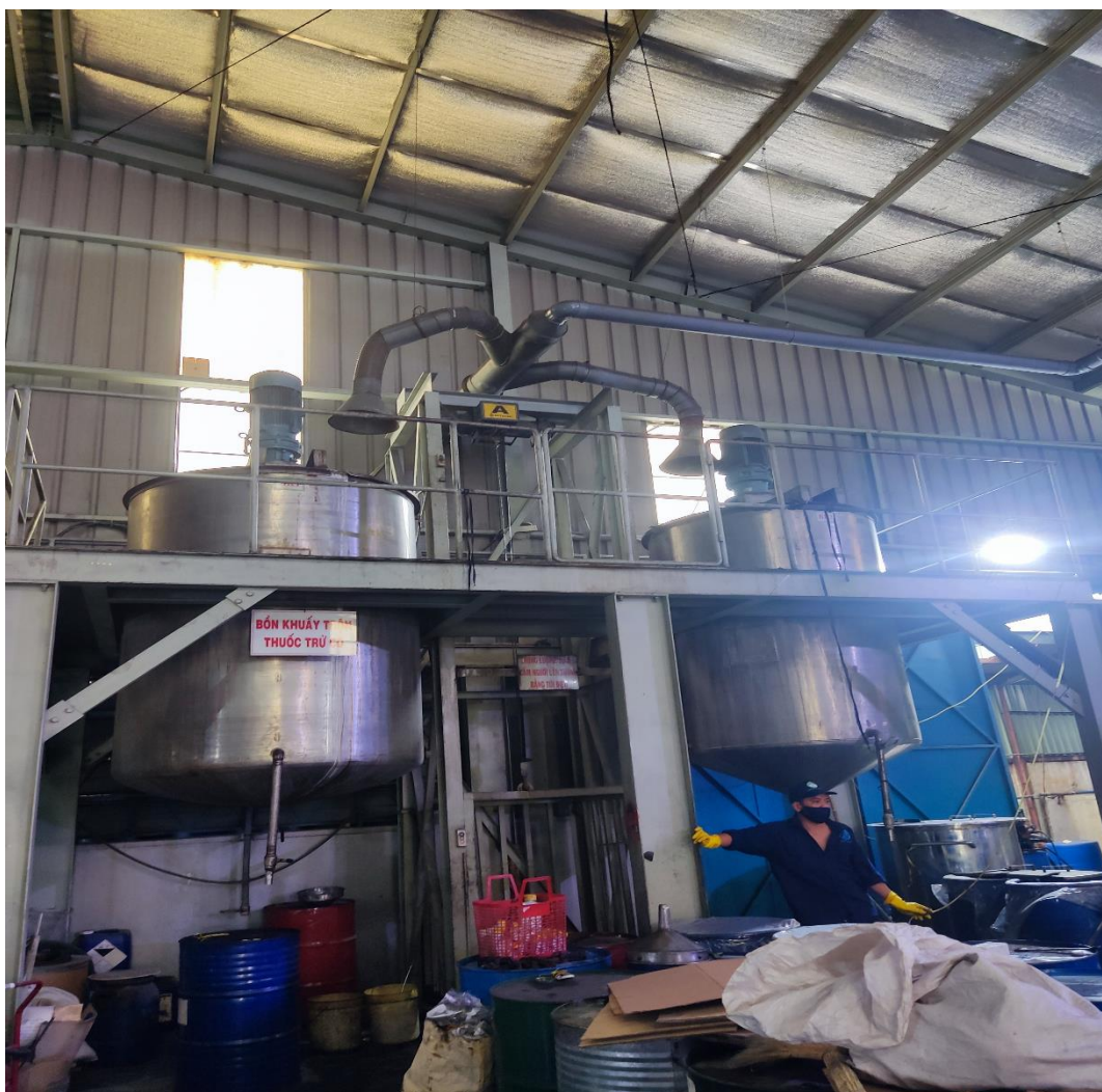
Hình 3. 5. Hình ảnh hệ thống thu gom khí thải từ thiết bị trộn và khu vực chiết rót
